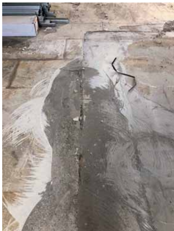
Totalschaden: Erst beim Abfräsen der alten Restschichten wurde deutlich, dass der alte Estrich nicht sanierungsfähig war. Der Bauherr folgte dieser Ansicht und ließ einen neuen einbringen.
